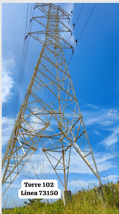
Figura 2 Torre de transmisión de 115kV. Fuente: Elaboración propia.
