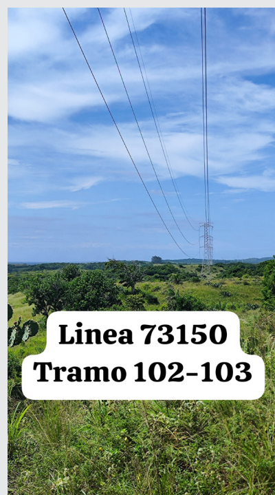
Figura 1. Tramo de la Línea 73150 de 115 kV Fuente: Elaboración propia.
